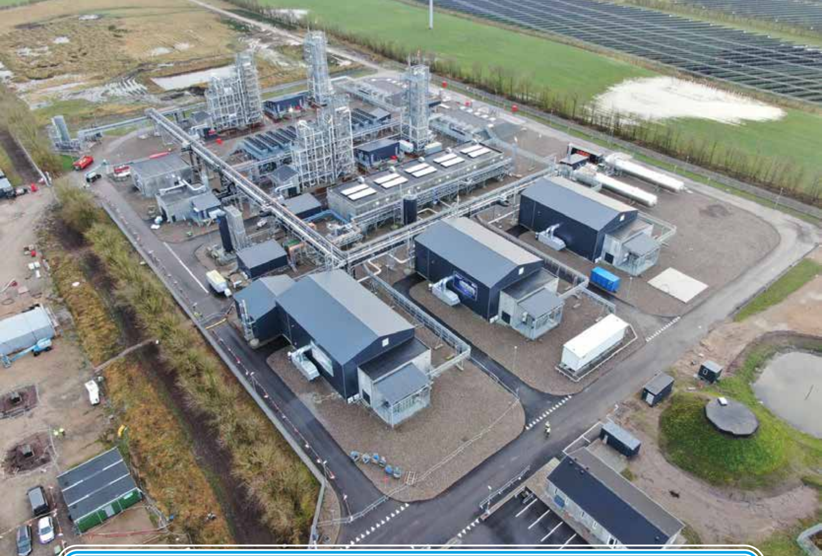
Planta industrial de e-metanol da EE na cidade de Kásso, na Dinamarca.
